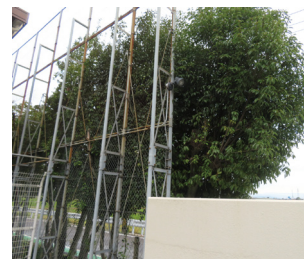
防犯フェンス
